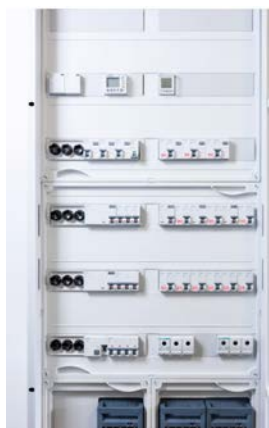
Rys 4. Rozdzielnica elektryczna z detektorami 5SM6 firmy Siemens zasilająca urządzenia w budynku.
